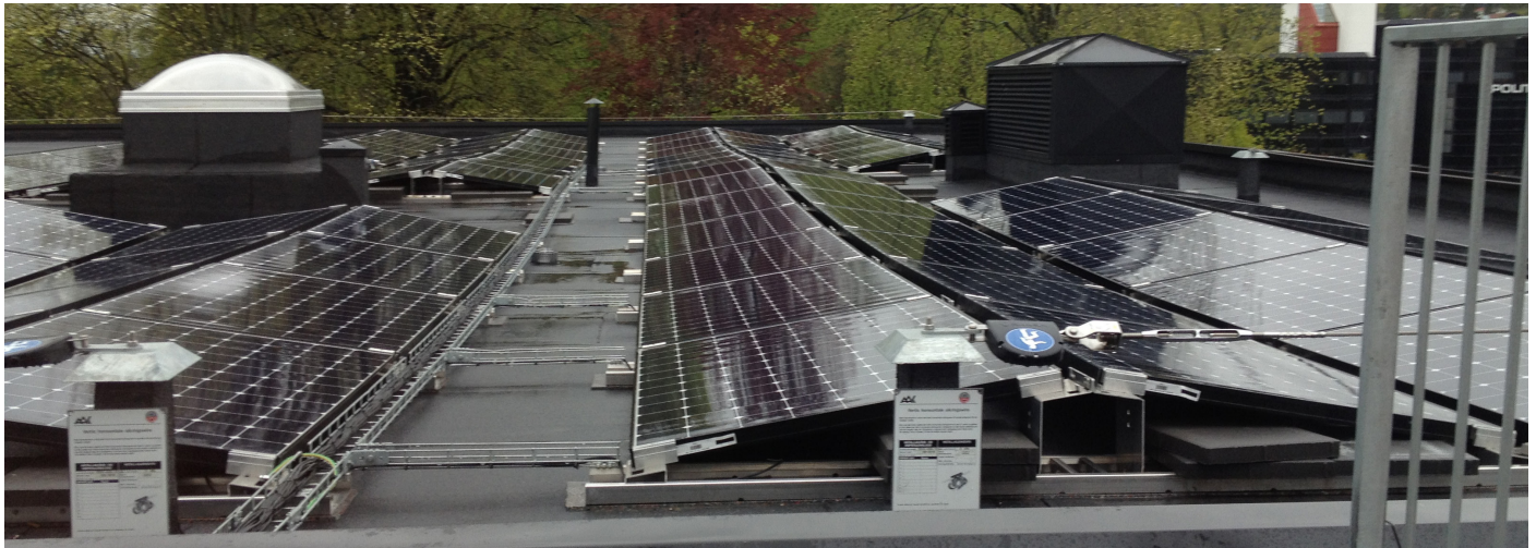
Photovoltaic panels on the roof of Powerhouse Kjørbo. Photo: Anne. G. Lien | Solcellepanel på taket til Powerhouse Kjørbo. Foto: Anne. G. Lien
