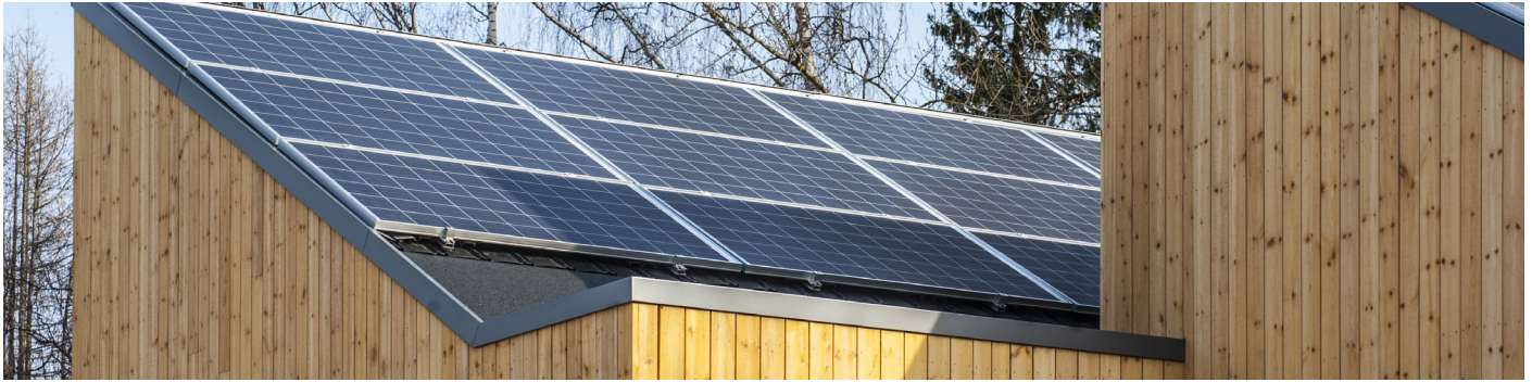
ZEB Living Lab, photovoltaic panels on the roof. Photo: Anne J. Bruland | Solcellepanel på taket til ZEB Living Lab. Foto: Anne J. Bruland
